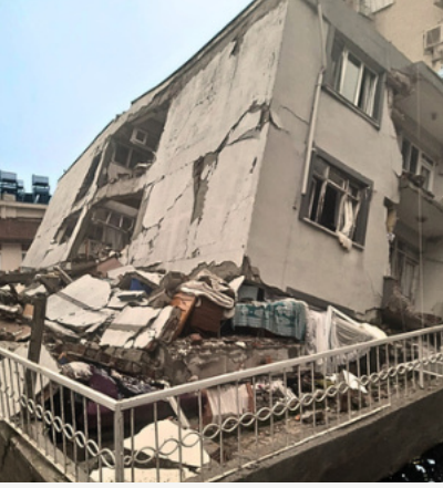
Das eingestürzte Wohnhaus ....
