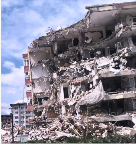
Ein eingestürztes Mehrfamilienhaus in Antakya
